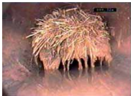
Ryc. 1. Intensywny przerost korzeni z nieszczelnego złącza z obszaru wierzchołka kanału, fot. autor
