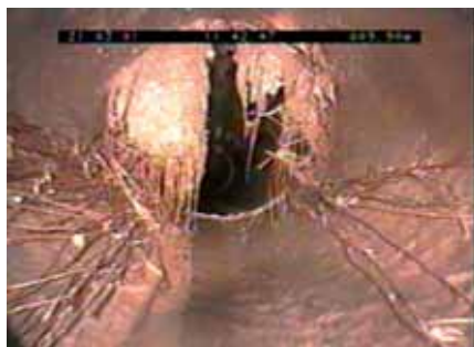
Ryc. 3. Przerost korzeni drzew z nieszczelnego złącza z obu boków kanału następnie rozrastających się wewnątrz wzdłuż kanału, fot. autor
