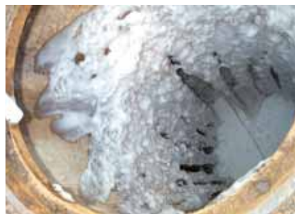
Ryc. 6. Korzenie w kanale pokryte pianą zawierającą substancję aktywną
